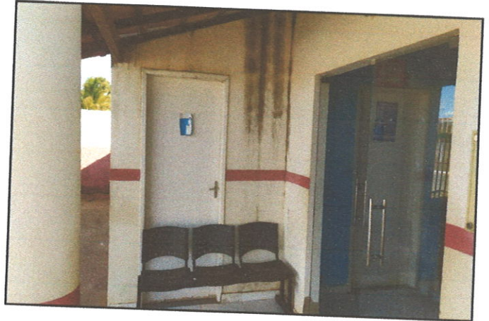
FIGURA 02 - Manchas na parede e porta danificada
