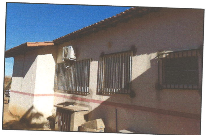
FIGURA 06 - Pintura externa danificada
