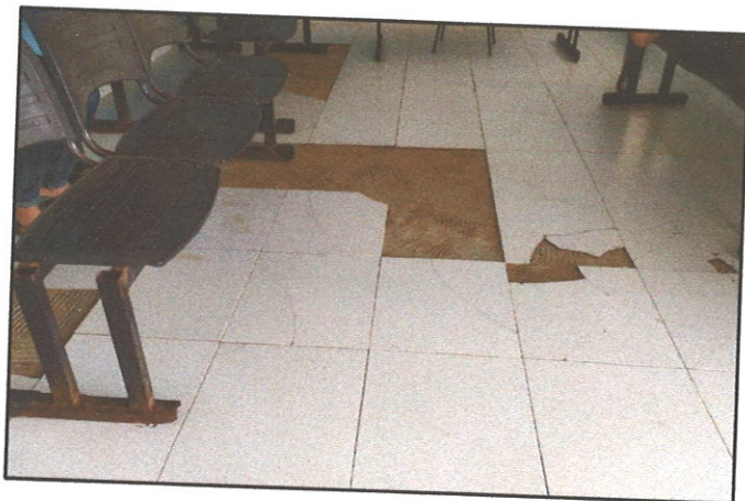
FIGURA 03 - Revestimento cerâmico quebrado
