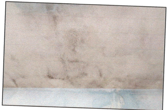
FIGURA 04 - Manchas no teto
